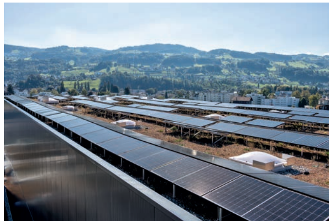
Auf dem Dach des neuen Hochregallagers wird nachhaltiger Strom generiert.
