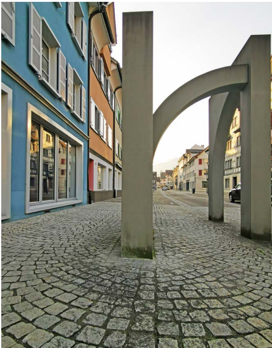
Diverse Risse und kaputte Steinfugen müssen repariert werden.
